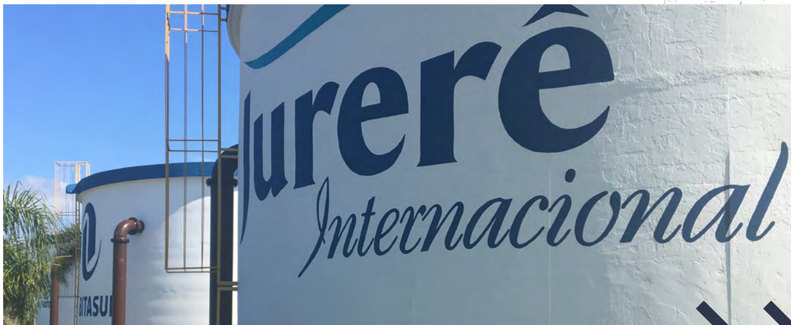
Reservatório SAE – Jurerê Internacional/SC
